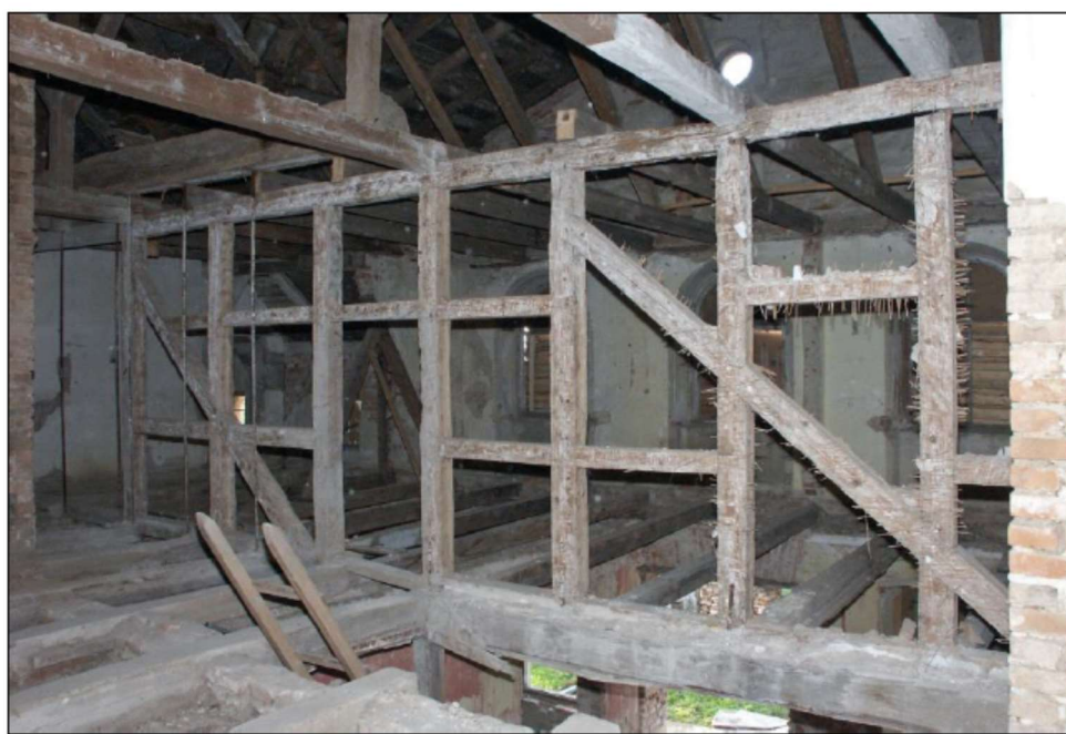
Poddasze, widok w kierunku facjaty w pseudoryzalicie, zdewastowany dźwigar ryglowy, stan z 2006 r.
