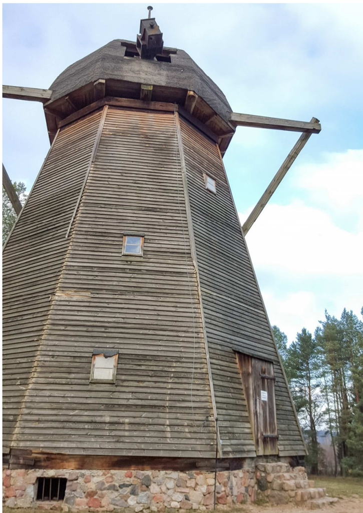
Fot.1. Uszkodzenia poszycia ścian spowodowane przez spadające skrzydła.
