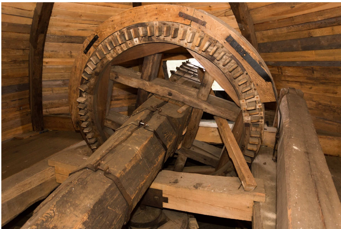
Fot.5. Wzdłużne pęknięcie wału śmigłowego. Z prawej strony prasa zaciskająca hamulec. Fot. Marek Kowalczyk 2015-11-10
