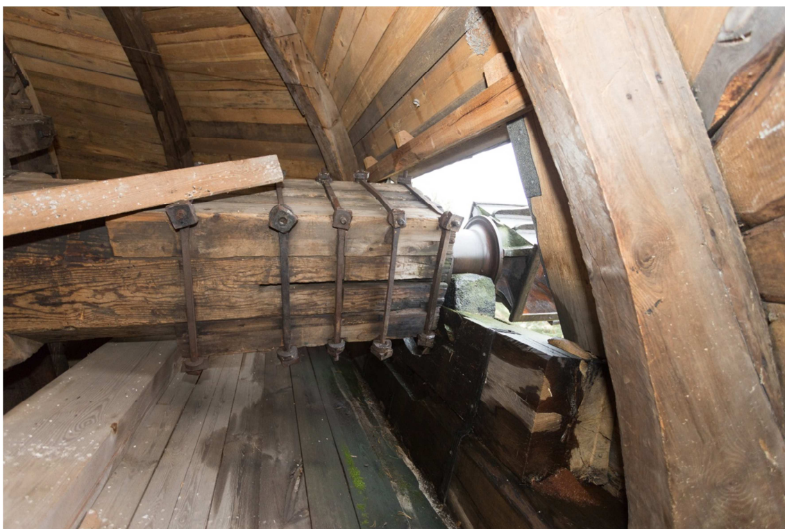
Fot.6. Silne zawilgocenie podwalnicy. Fot. Marek Kowalczyk 2015-11-10
