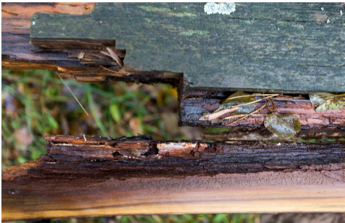
Fot.3. Przełom ujawnia korozję drewna szpicy w sąsiedztwie szczelin.
